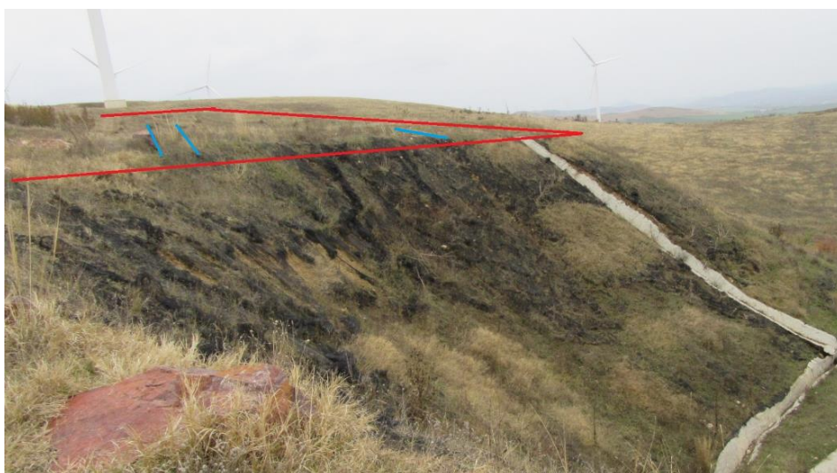
Fig. 8.2 Vedere laterală a platformei (linia roșie - limita platformei; liniile albastre – crăpături la suprafață)
