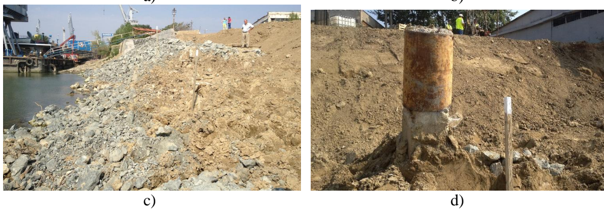
Fig. VI.177: Detalii ale zonei afectate: a) vedere de sus; b) ebulment; c) vedere de jos; d) pilot de acostare
