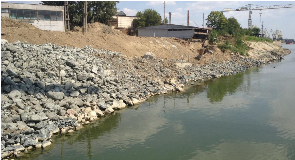
Fig. VI.175: Imagine de ansamblu a zonei afectate
