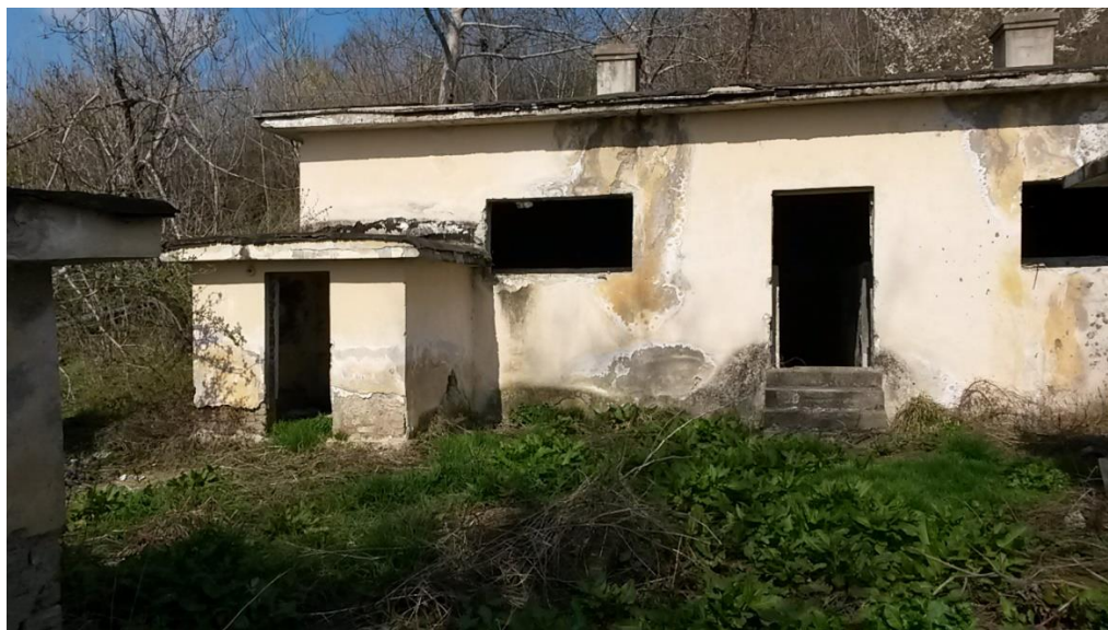
Fig. 5.39: Stația de tratare
