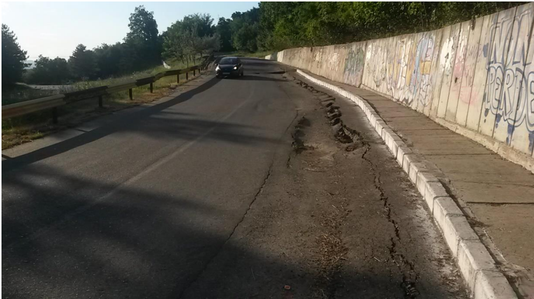
Fig. 5.33: Detaliu – Suprafața de cedare „Zona 1” (poza este făcută în sensul de urcare)
